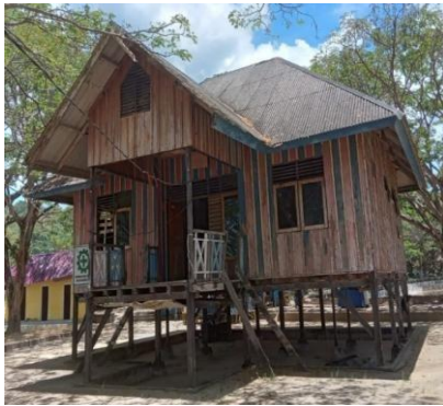
Gambar 3 : Penginapan yang sering dijadikan tempat menginap wisatawan. Tampak kondisinya rusak berat, sehingga tidak dapat difungsikan lagi.
